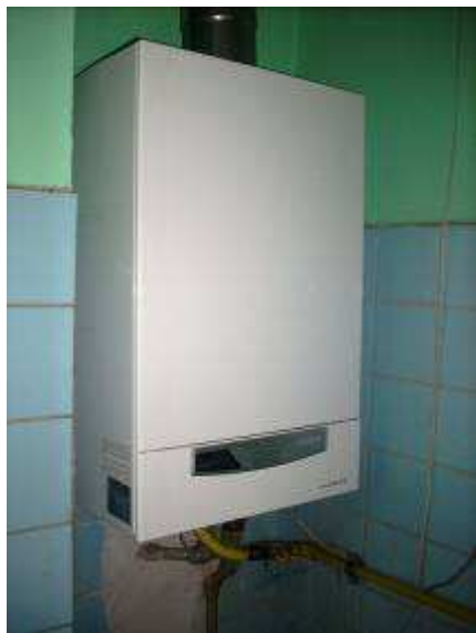
Rysunek 11 piec gazowy zasilania instalacji centralnego ogrzewania
