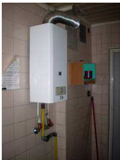
Rysunek 10 piec gazowy podgrzewu c.w.u. zainstalowany w pomieszczeniu kuchni
